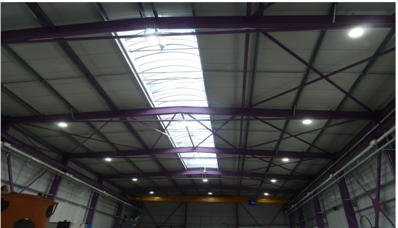
Oblicht mit RWA-Anlage und Absturzsicherung
